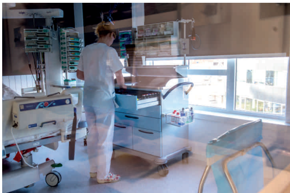
Twee isolatieboxen met toegangssluis en een aangepast over- en onderdrukstelsel beschermen patiënten wiens immuniteit gecompromitteerd is tegen schadelijke invloeden van buitenaf.
